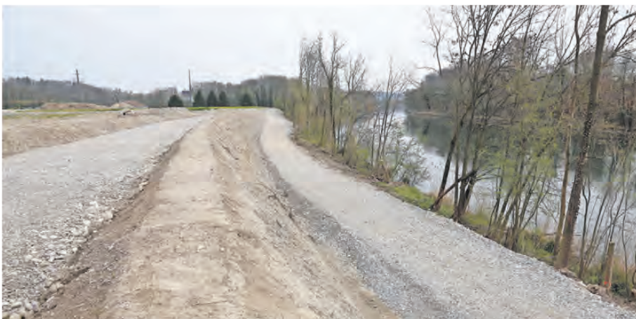
Die Werkstrasse zum Kieswerk nimmt Formen an, so sah es letzten April entlang des Aareufers aus.
